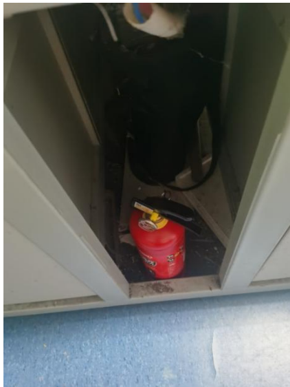
理科楼 A101—灭火器未配置架子、无点检记录卡 负责人董慧（复查新增）
